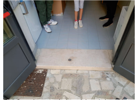
Es. infisso che aprendosi parzialmente ingombra il passaggio
